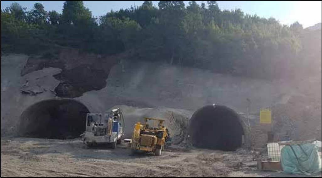
Pamje nga Tuneli i Murrizit, shembur në maj 2019. Ky kantier është braktisur. Shembja që duket në foto është bërë për shkaqe sigurie.
